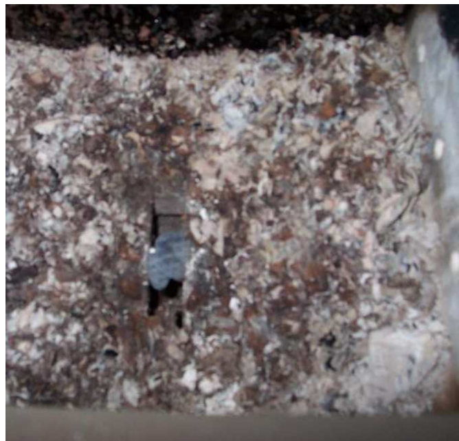
Bild 2 : Verschmutzung vorderer Filterkammerbereich
